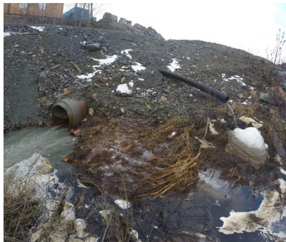
Påvirkning fra sigevann fra nedlagt avfallsdeponi.
