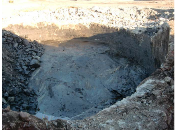
Rensket ned til fjell inne i kreosottank.
